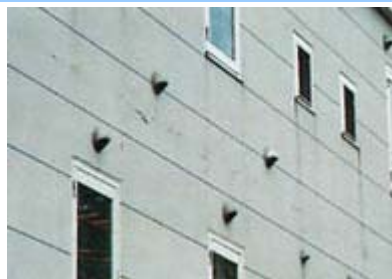
外壁材が所々破損している。
